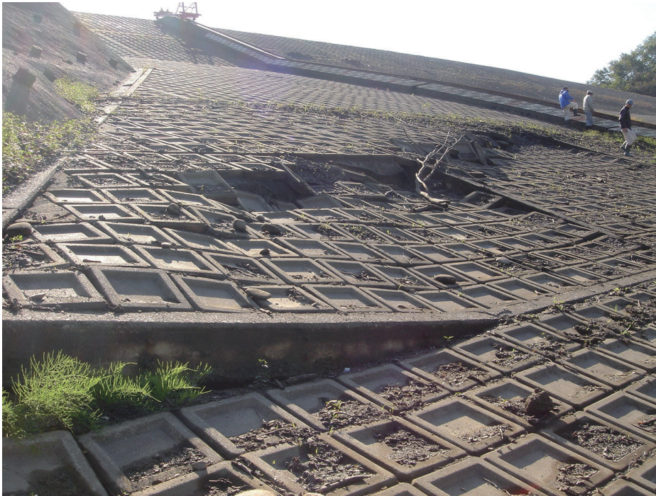
図一 Aダム、左岸崩壊部（下流より見たもの） 9
