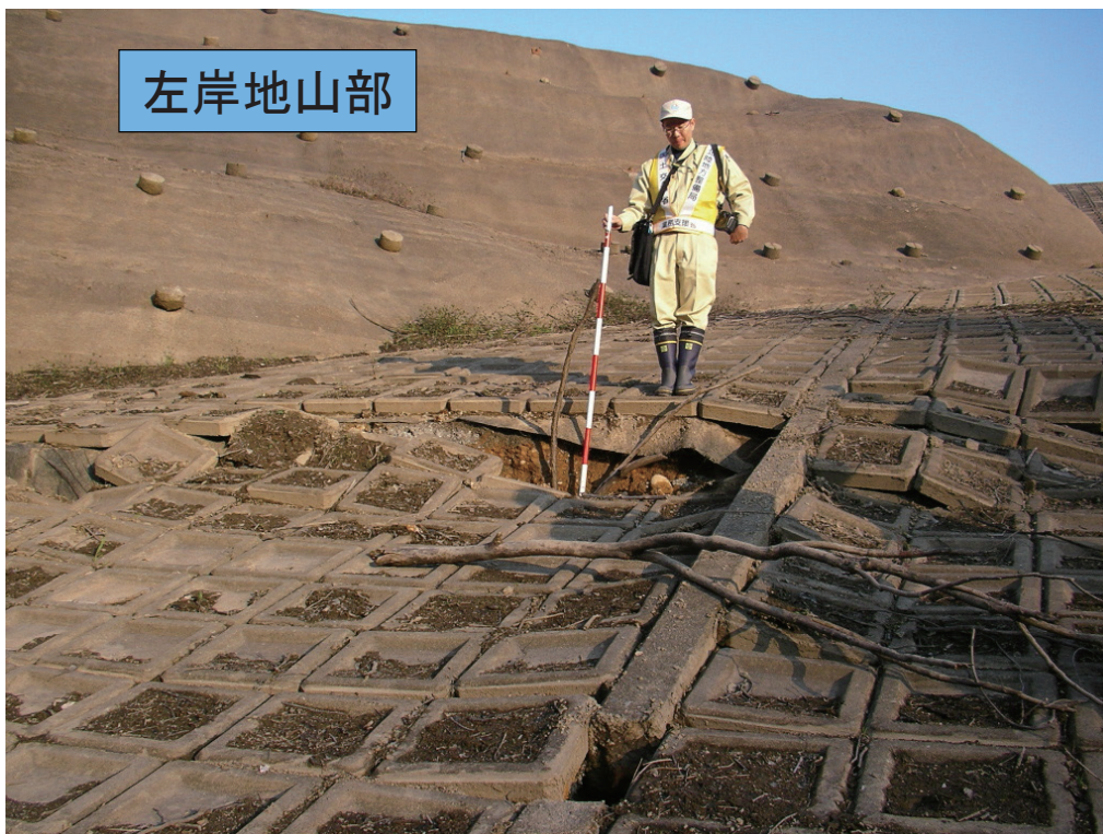
図一 Aダム、左岸崩壊部（下流より見たもの）
